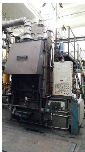
Рис. 6. Электрическая печь для закалки Unitherm UGKUQ 70/65/110
